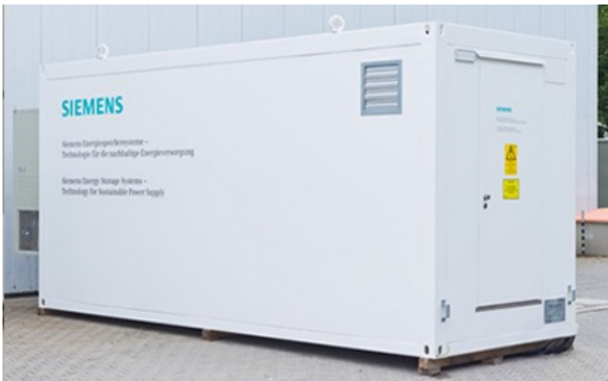
Fot. 5. Przykładowy kontenerowy magazyn energii, za www.siemens.com . U góry widać uchwyty przeładunkowe.
