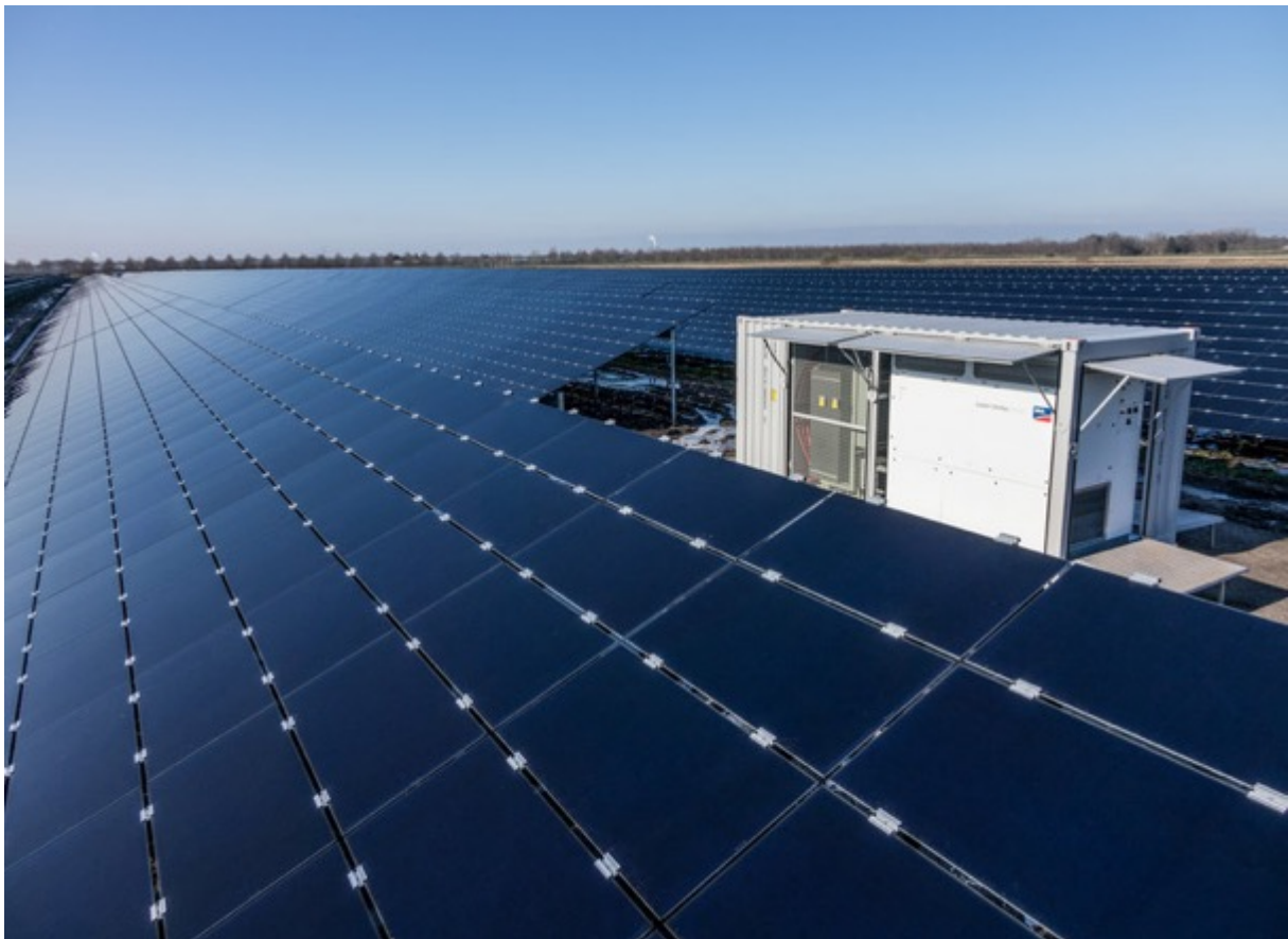
Fot. 4. Przykładowa kontenerowa stacja rozdzielająca wraz z transformatorem (źródło: www.belectric.com ).
