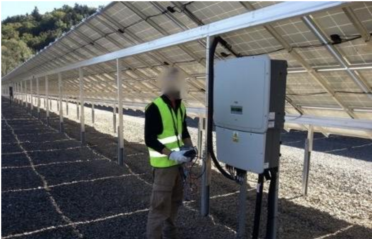
Fot. 3. Przykładowa instalacja zamontowana pod konstrukcją paneli na jednej z pracujących w Polsce farm fotowoltaicznych w Tymbarku (źródło: www.solgen.pl ).
