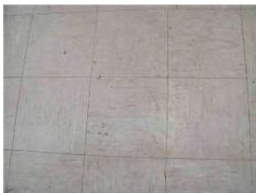
Rys. 8 Płyta podłogowa azbestowa
