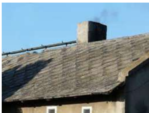
Rys. 4 Płyta azbestowo-cementowa karo
