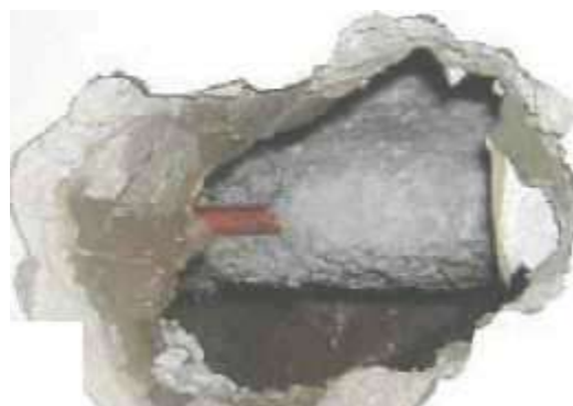
Rys. 7 Azbestowa izolacja rury
