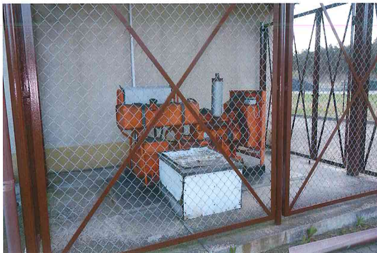
Zdjęcie 27. Agregat prądotwórczy Oczyszczalni Ścieków w Widawie
