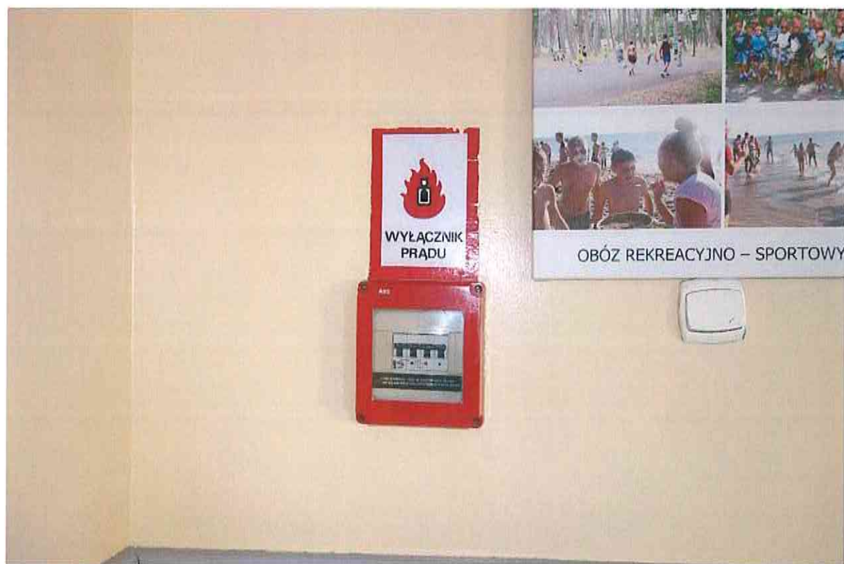
Zdjęcie 20. Przeciwpożarowy wyłącznik prądu w Zespole Szkół w Widawie
