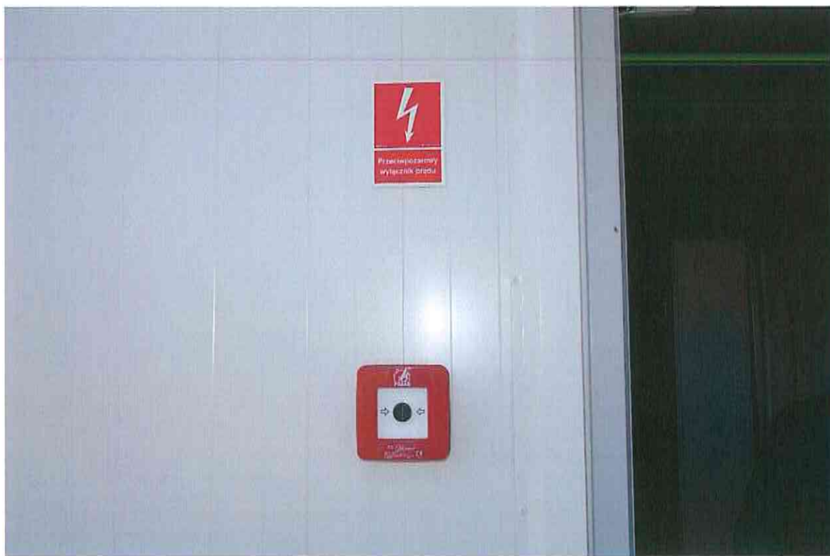
Zdjęcie 34. Przeciwpowodowy wyłącznik prądu na ścianie Hydroforni w Goryniu
